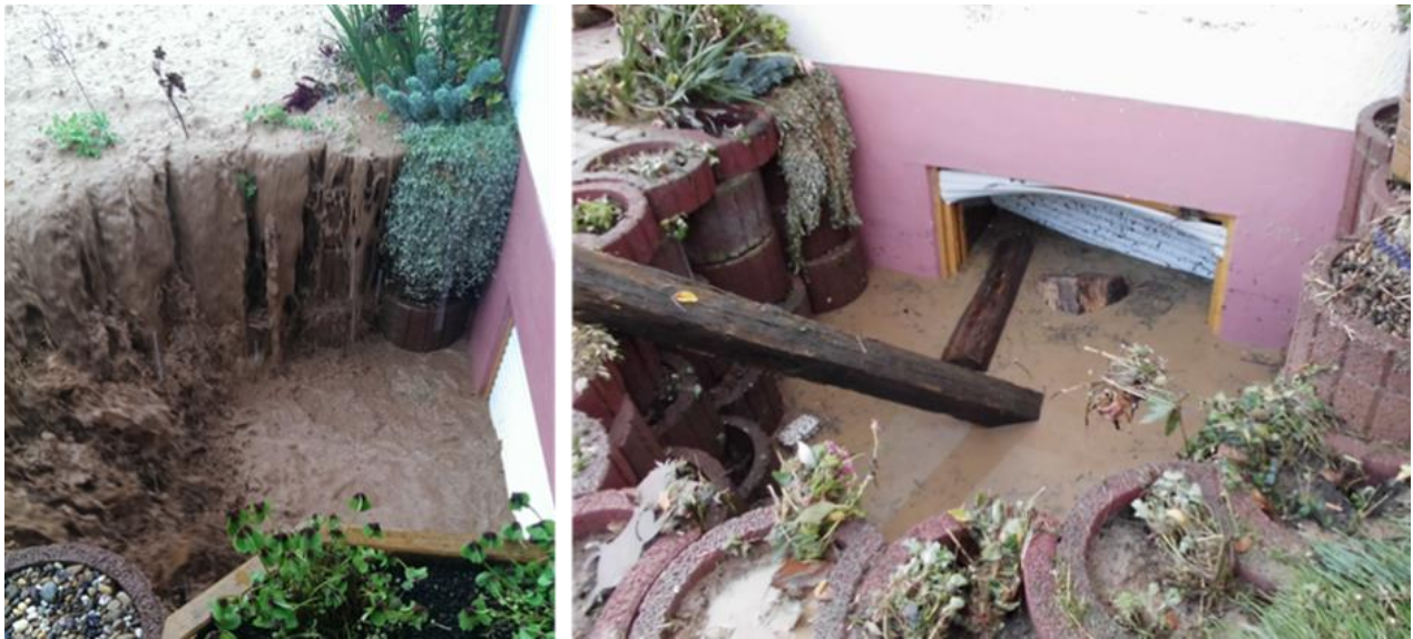
Abb. 15: Überflutete Souterrainwohnung im Moscheltal 2014
