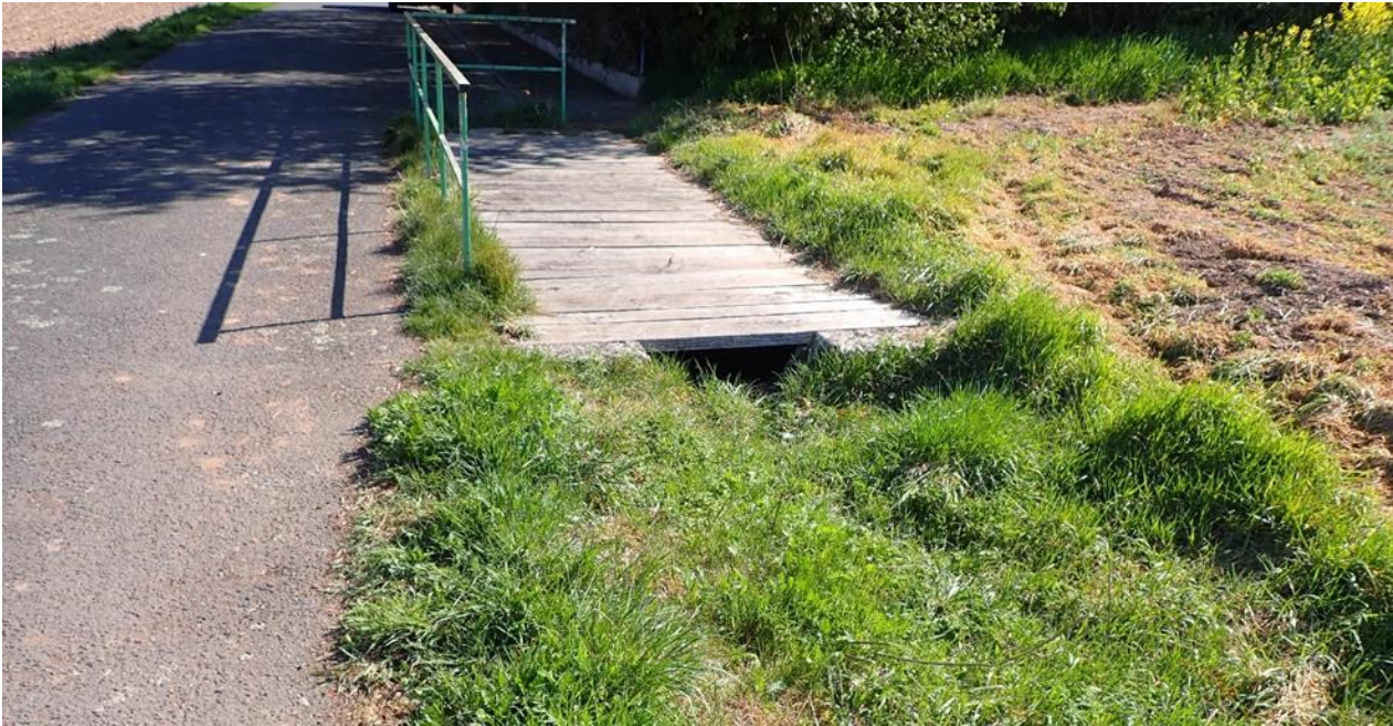
Abb. 71: Sandfang am Wirtschaftsweg in Verlängerung der Herlenbergstraße
