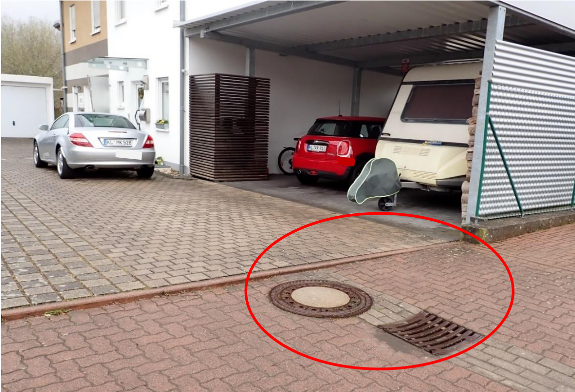
Abb. 33: Überstaugefährdeter Straßenablauf und Kanalschacht im Geländetiefpunkt
