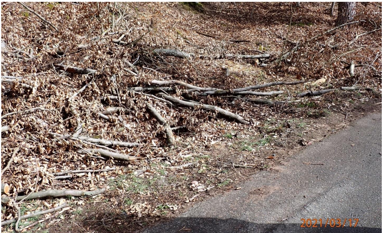
Abb. 59: Wegseitengraben mit Abflusshindernissen
