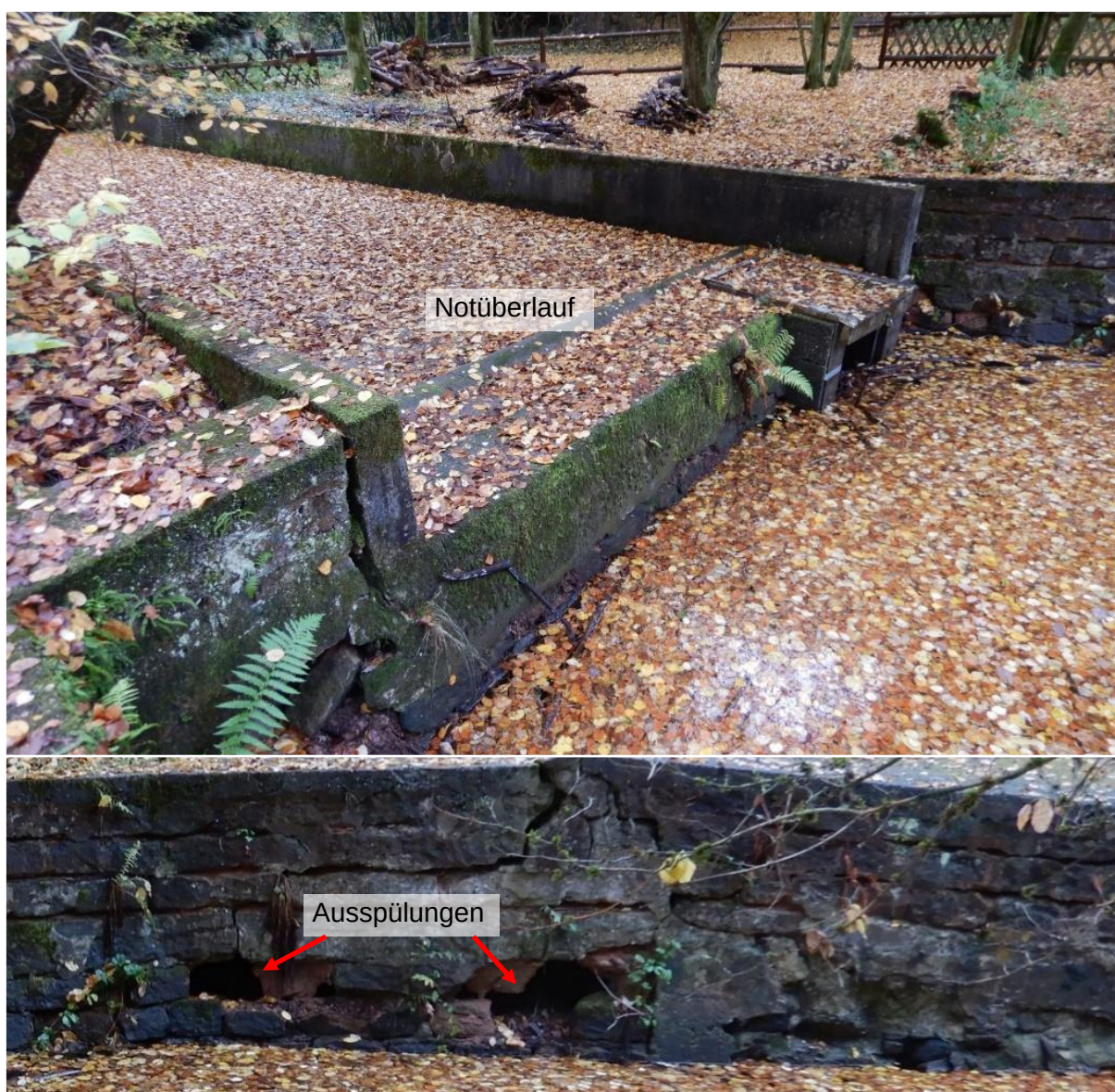
Abbildung 15 Situation Woog am Glasbach, ausgespülte Mauer
