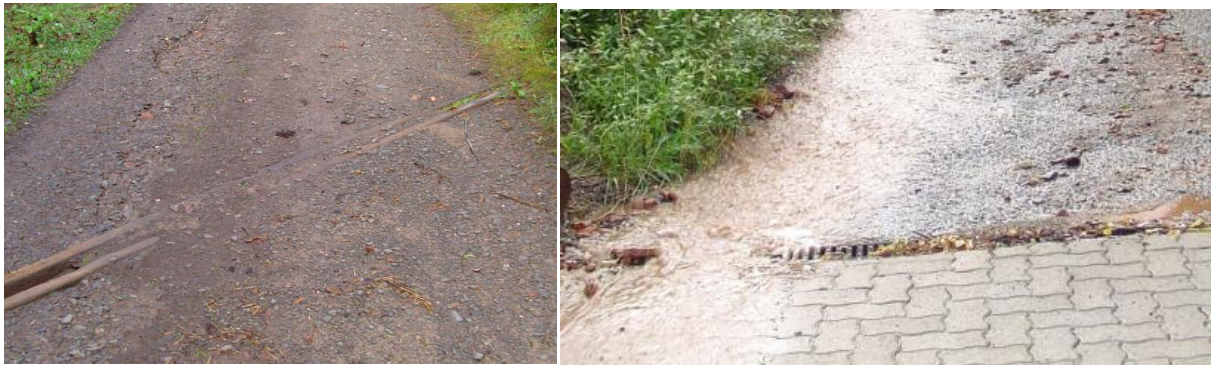
Abbildung 9 vorhandener, für Starkregen ungeeigneter Querabschlag und Außengebietswasserfassung
