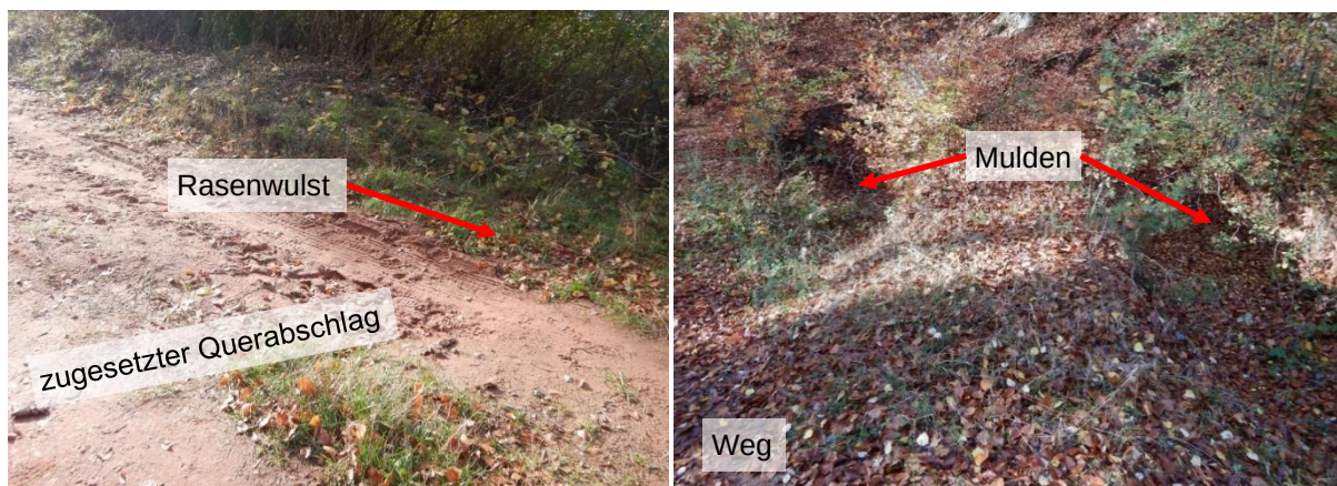
Abbildung 20 Querabschlag und Mulden am Wirtschaftsweg Elmsteiner Str. zum Leinhoferberg
