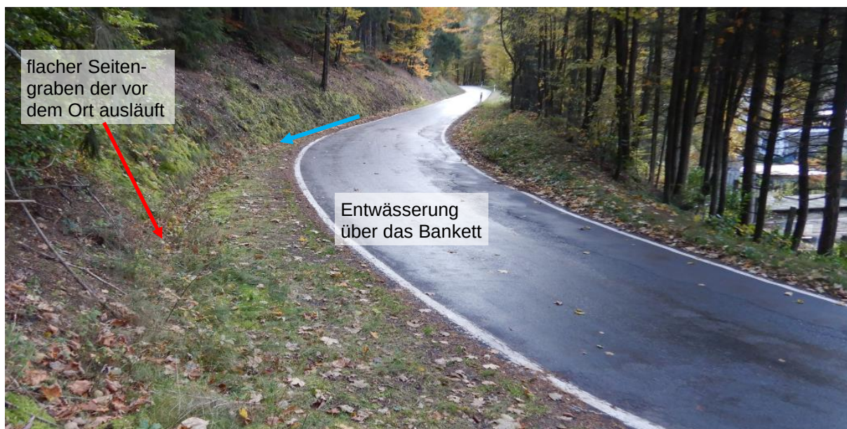
Abbildung 13 L504 am südlichen Ortseingang oberhalb Bebauung Elmsteiner Straße
